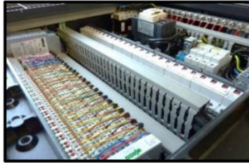
Ilot Ethernet intégré dans la baie
